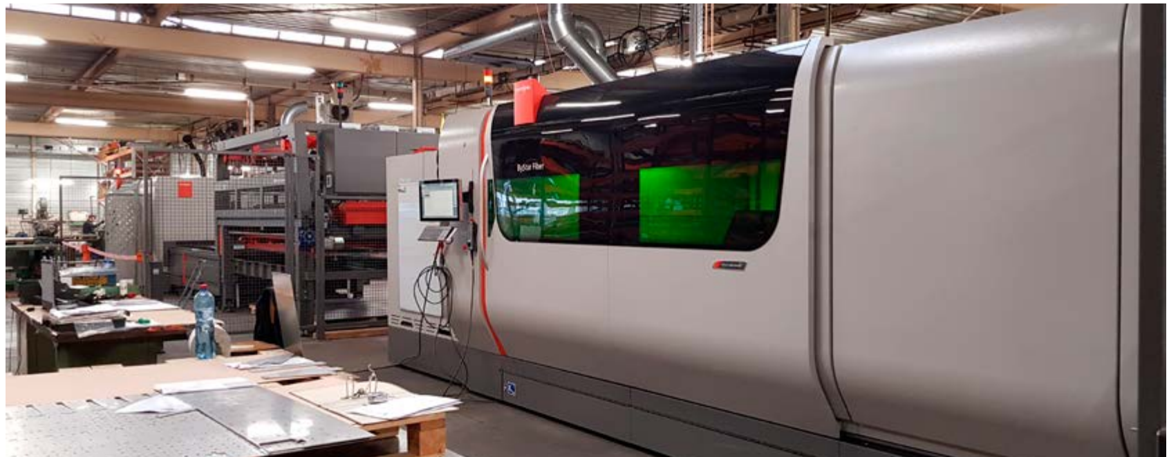
De twee lasersnijmachines, waaronder de nieuwe 8 kW fiberlaser van Bystronic, die eerder dit jaar is geïnstalleerd, staan al op de goede plek.
